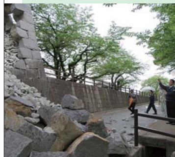
▲倒壊した熊本市の石垣
