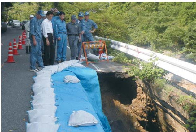
▲道路陥没を視察
